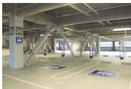
⑧ EV充電設備 (3階) 電気自動車等用充電設備を5台設置
