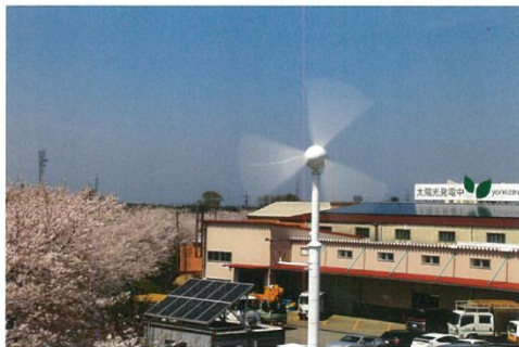
ハイブリッド発電設備設置（米沢電気工事 本社）
