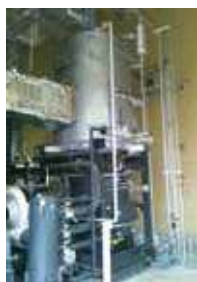
バイオマスボイラー
