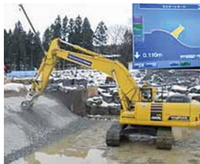
ICT活用のコンクリートはつり工事 (ツインヘッダー採用)
